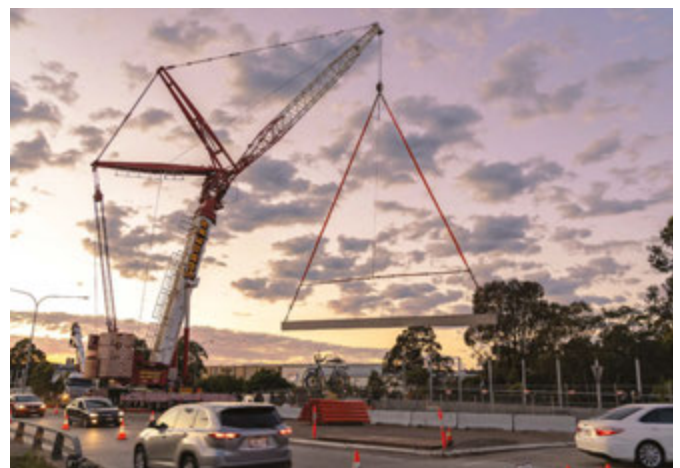
Công trình xây dựng cầu cáp Muir Road vào cuối tuần kéo dài trong tháng 10
