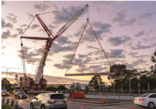
القيام بالأعمال على الجسر المدعوم بالكوابل في Muir Road خلال عطلة نهاية الأسبوع الطويلة في تشرين الأول/أكتوبر
