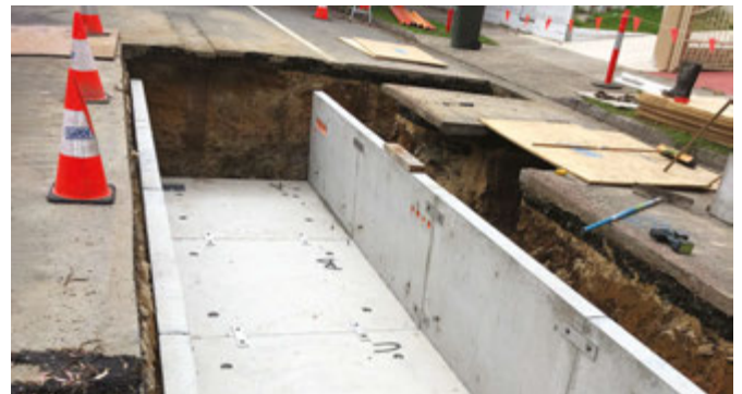
Lắp đặt các hầm nối kết cách nhau khoảng 900 mét dọc theo tuyến cáp và xây dựng rộng hơn rãnh
